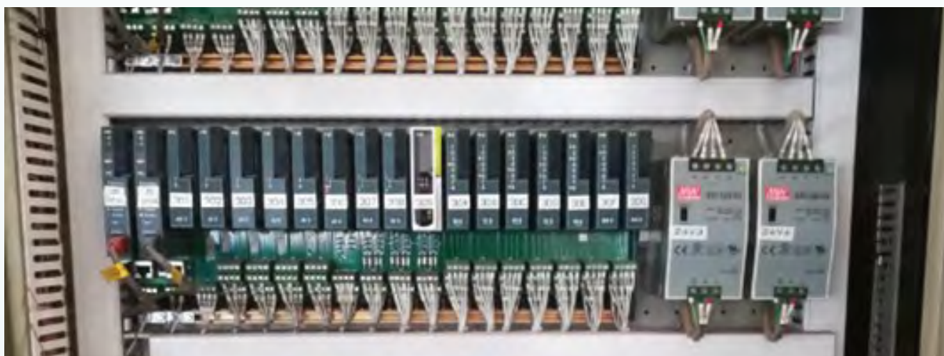
天瑞集團鄭州水泥有限公司回轉窯餘熱發電控制站
