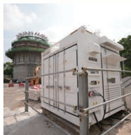
電池儲能系統 (BESS)
