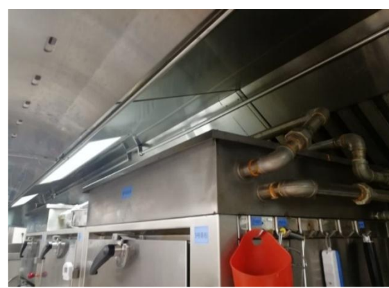
(圖：蒸汽回收轉換熱水設備，善用能源，物盡其用)
