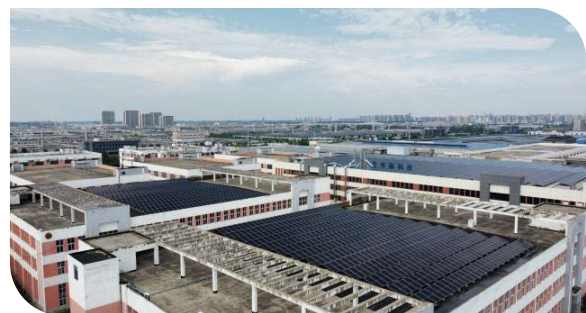
▲ 光大宿城開發區屋頂光伏發電項目於二零二四年十月併網發電，設計發電裝機容量為 40 兆瓦，是本集團裝機容量最大的光伏項目。
