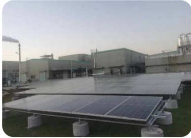
溫嶺固廢處置項目利用廠區內的廠房屋面、事故水池及初期雨水池等位置建設光伏項目，安裝面積約 12,000 平方米，總安裝容量約為 1.6 兆瓦。
