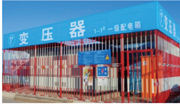
箱式變壓器防護
