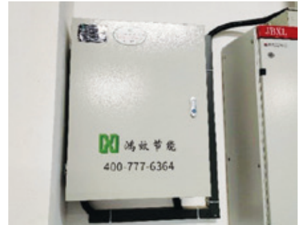
M4公寓新增高區及中區共用節能水泵
