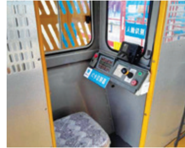
施工電梯司機人臉認別系統
