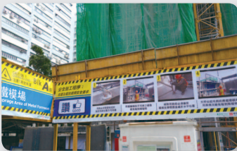
為司機提供清晰警告告示
